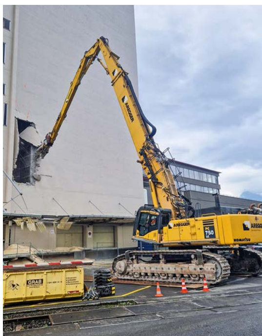
Stefan Gwerder schneidet die Aussenwand der defekten Reiskammer sauber raus.
